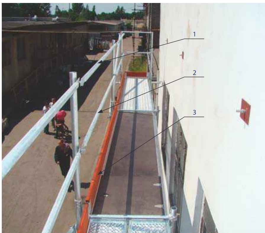
Fot. 7. Zabezpieczenie rusztowania (poręcz główna – 1, poręcz pośrednia – 2, bortnica – 3)
