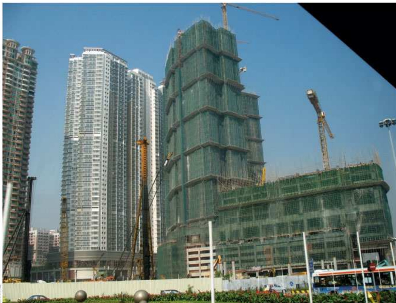
Fot. 2. Wykorzystanie bambusowych rusztowań na nowoczesnej budowie. Na zdjęciu widoczne daszki ochronne (tzw. catch fans)
