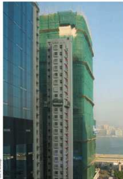
Fot. 3. Na zdjęciu widoczne daszki ochronne (tzw. catch fans) oraz na jednej z kondygnacji rusztowanie oparte na konsolach
